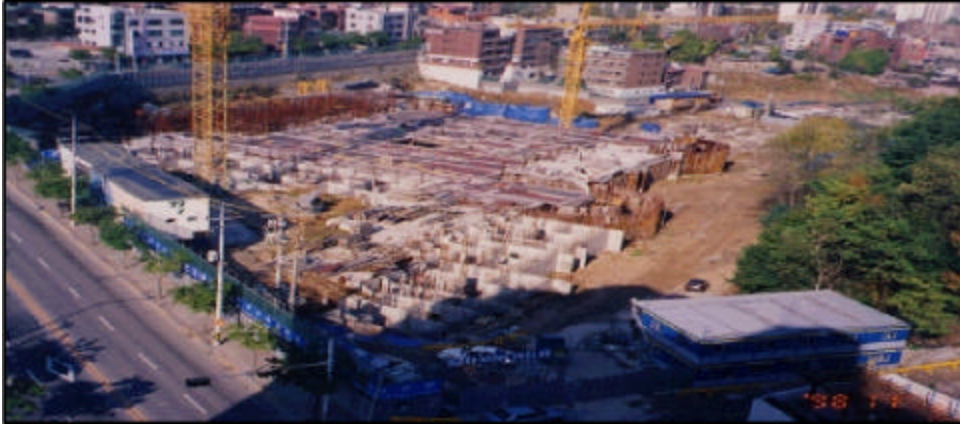
<철근부식된 변동 석탑아파트 현장전경 (철근부식기간 : 97.12 ~ 98.11)>
