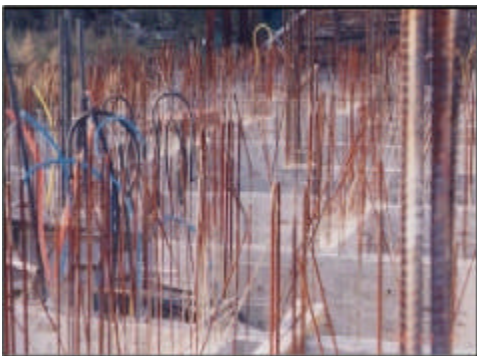
<기시공 부식철근 현황>
