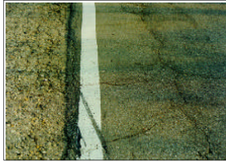
<그림 2-2> 단부 균열
