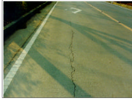
<그림 2-4> 세로 방향 균열
