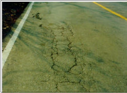
<그림 2-1> 거북등 균열
