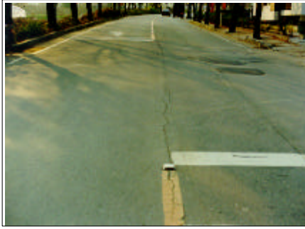
<그림 2-3> 시공 균열
